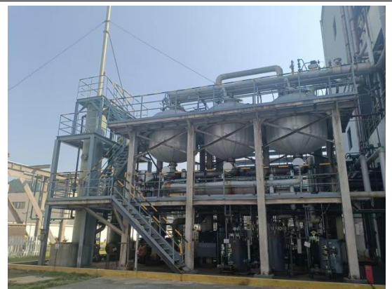
废气处理设施 2
