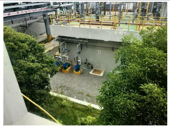
污水处理站污水收集池
