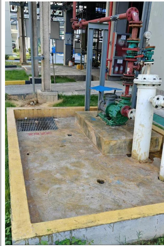
甲类生产车间一污水收集池
